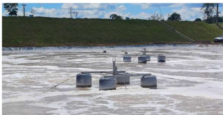
Aerador Tornado Biturbo em indústria Laticínios
