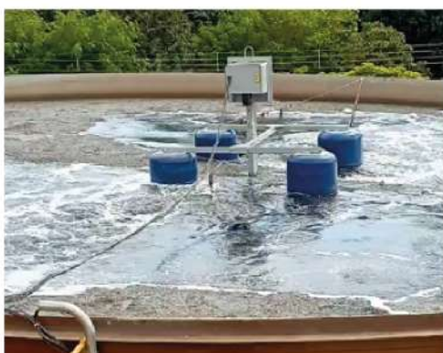
Aerador Tornado Biturbo Rotativo em tanque
