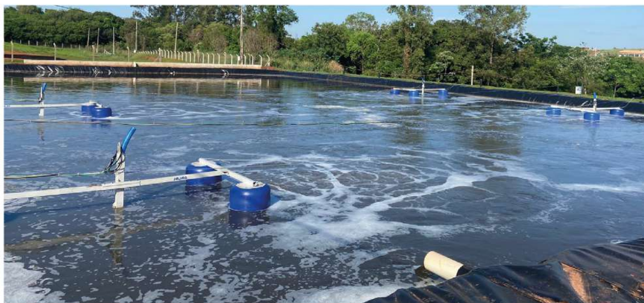
Aeradores Tornado operando em lagoa de tratamento
